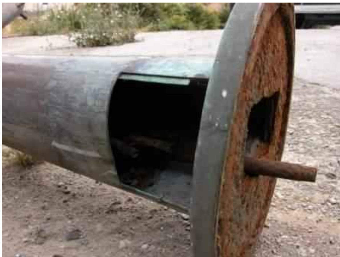
Zkorodovaná kotevní deska, chybějící dvířka a poškozené vnitřní rozvody vody.
