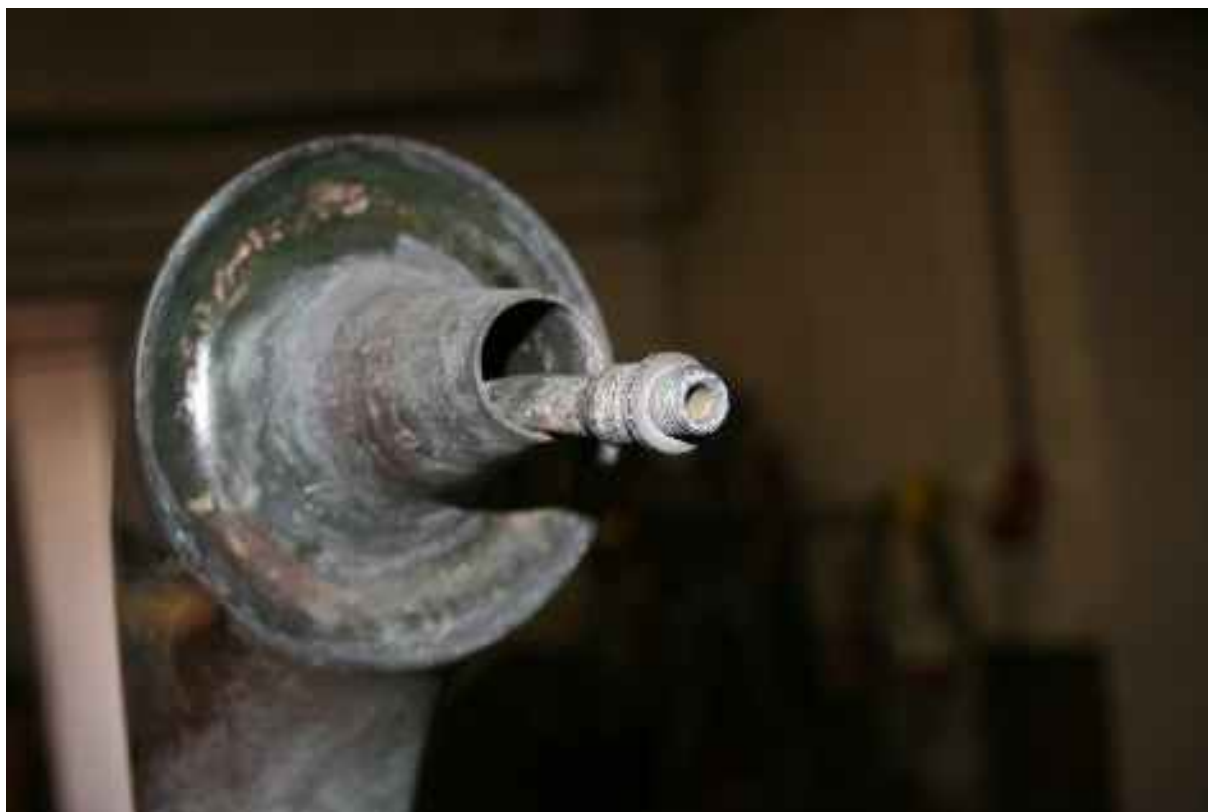
Detail zakončení velkého ramene, stav před restaurováním.
